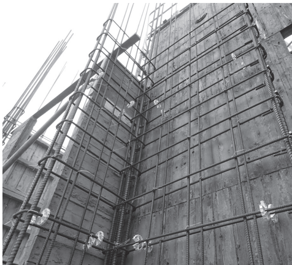
▲「傳統工法」牆轉角鋼筋組件眾多，綁紮繁複；施工品質控管不易，轉角未符合結構標準圖之封閉圍束，受地震力容易造成牆體裂漏水問題。
