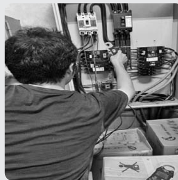
▲ 設備耗電量測。
